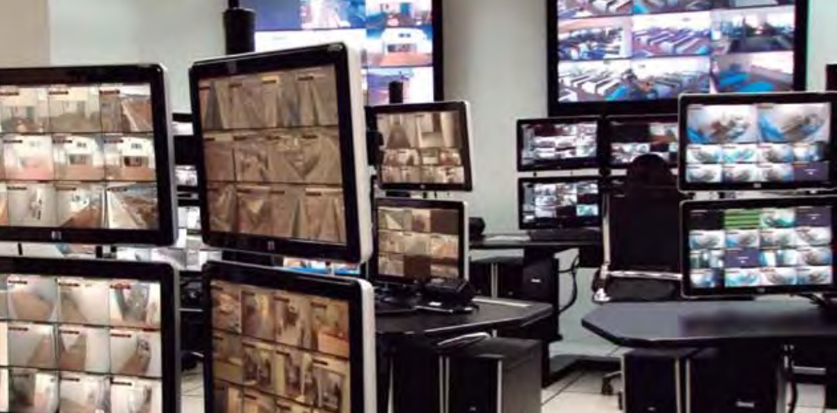
Centro de Control.
